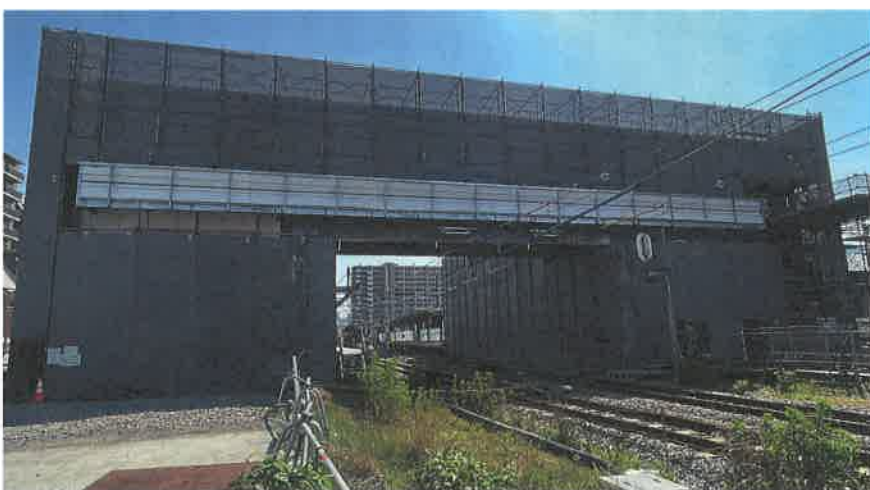
工事状況写真 6月20日時点 (広島市提供) 自由通路の形が見えてきました
