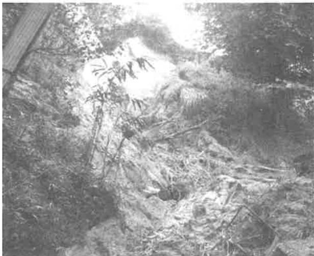
(学区内の裏山法面崩落現場)
