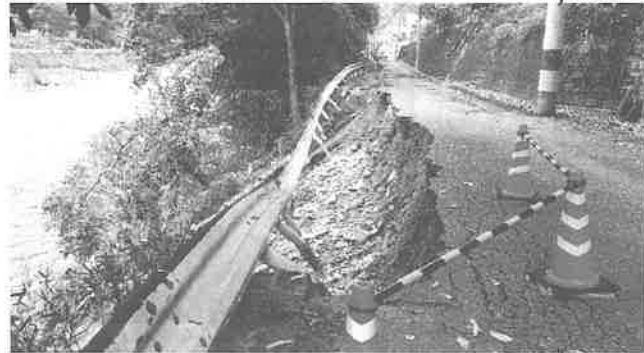
太田川沿い、大野～中河内線の一部で土砂崩れ。車は通行止めとなり、バスは対岸を通行しています。
