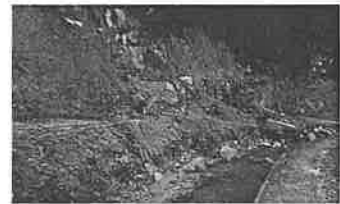
土砂が川に流れ込む河岸の様子 改修中の矢口川護岸。工事中だったため護岸の一部で土砂が崩れて、住民の不安を駆り立てた。
