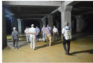
浸水対策用貯留槽の内部
