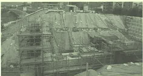
排水を太田川に導入するため埋め戻されるコンクリートボックス
